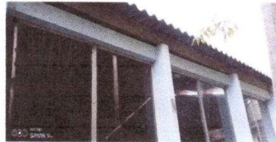
Foto 8: Corredor de sanitarios: Sustitución de canal de pvc, Sustitución de bajada de agua pluvial de metal por tubo PVC 3"
